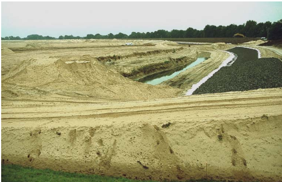
September 2001 Westteil: Das Südufer während der Bauphase: der Deichfuß wird angelegt, die Abgrabungen zur Entwicklung der künftigen Wattflächen haben begonnen; Blickrichtung Ost
